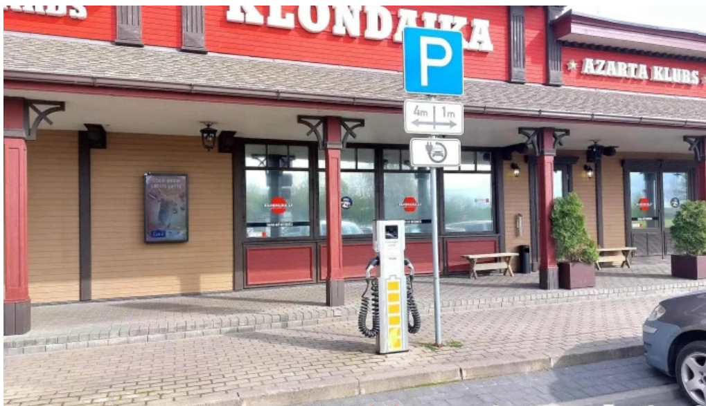
Elektrum drive uzlades stacija arejais izskats
